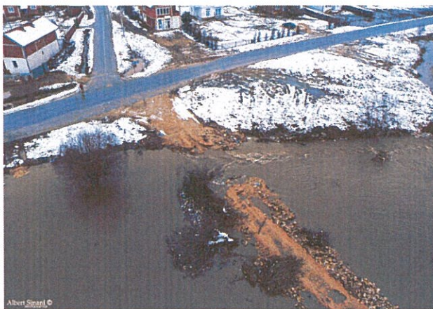
Foto 43 Dëmtimi i trupit të rrugës lagjia Avdyli-Shala
