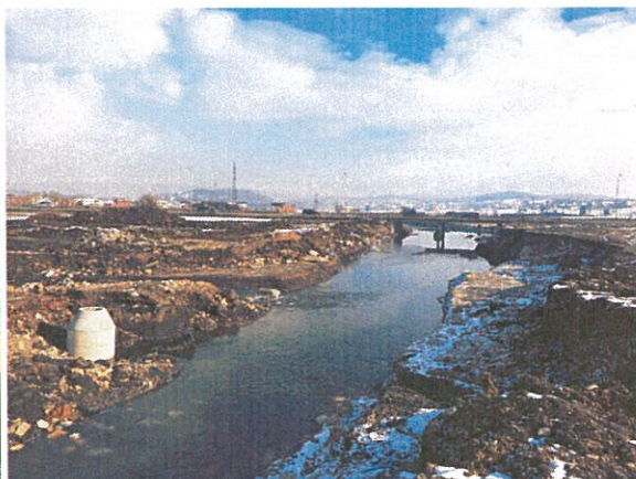
Foto 40 Dëmtimi i shtratit të Lumit, Dëmtimi i kolektoreve të ujerave të zeza në Poklek të Ri
